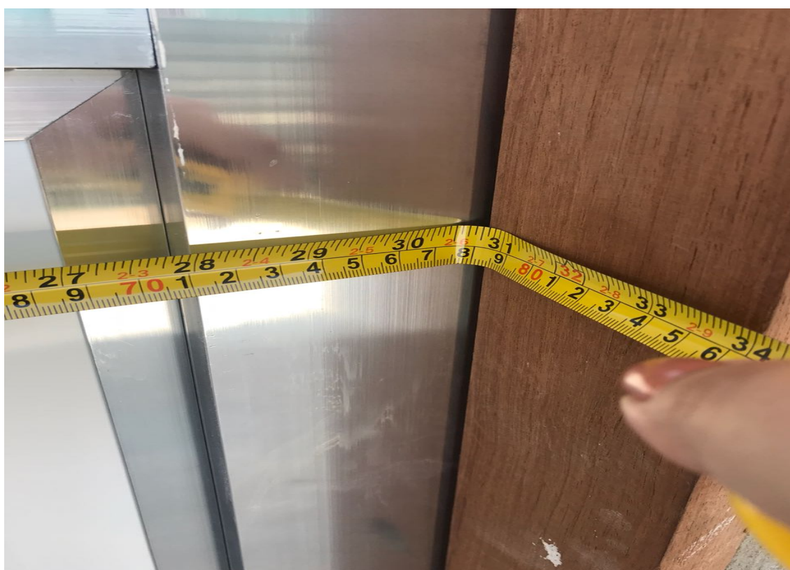
Figura 18: Porta de acesso ao banheiro PNE - bloco C
